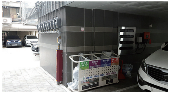
검침용 기기(세대 외부에 설치)
