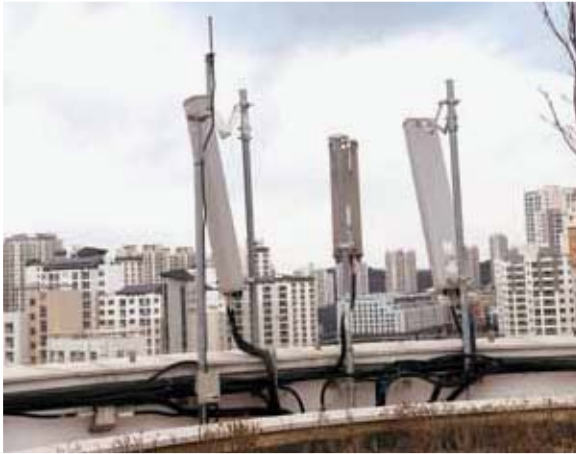
건축물 옥상에 설치된 통신기지국 장비
