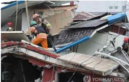
[그림 1-1] 진주 리모델링 붕괴사고 현장
