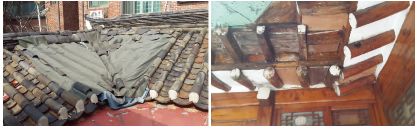
[그림 3-6] 지붕 회침 부위의 누수에 의해 처마가 손상된 모습
