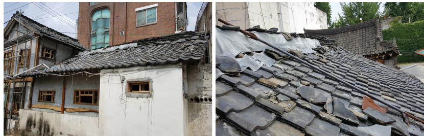
[그림 2-14] 리모델링 당시 노후화된 지붕
