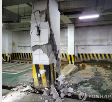
② 고양 마두역 인근 상가건물 지하 기둥 파열
