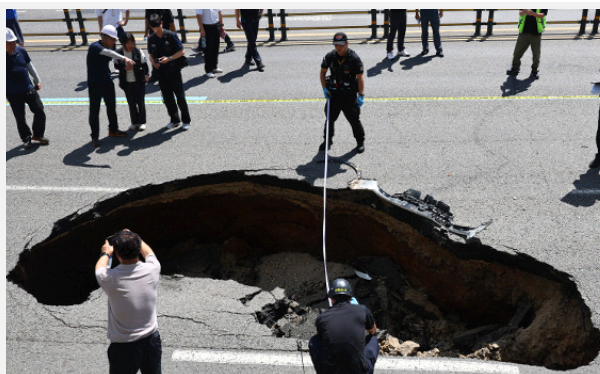
[그림 4-4] 서대문구 성산로 싱크홀 현장
