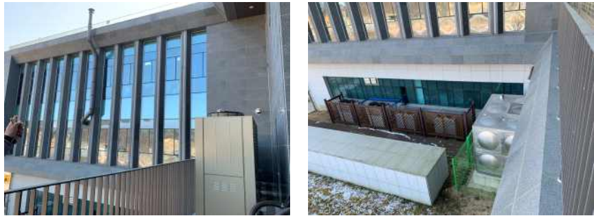
[그림 3-5] 배기시설, 냉방시설, 폐수저장시설의 개별 설치 현황 출처: 연구진 촬영
