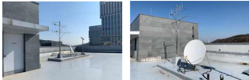
[그림 3-6] 통신설비 개별 설치 현황 출처: 연구진 촬영
