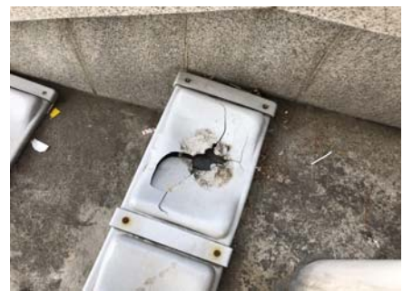
휴게 시설 파손 상태
