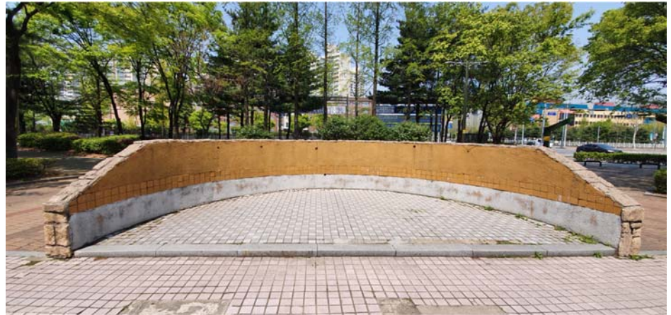
다목적광장의 열악한 관리 상태 (대촌공원)
