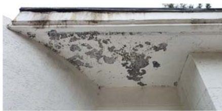
화장실 도색 벗겨진 상태 (희망공원)
