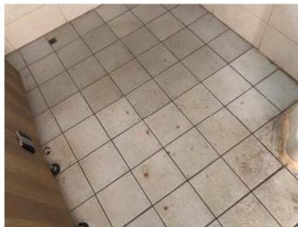
열악한 화장실 바닥 관리 상태 (세영공원)
