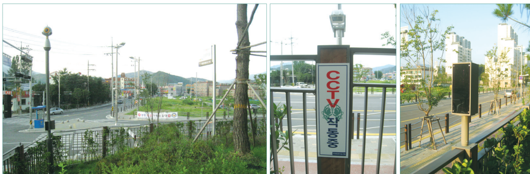
[그림 4-32] 단지 경계부에 설치된 CCTV 및 표지판, 적외선 인체 탐지기
