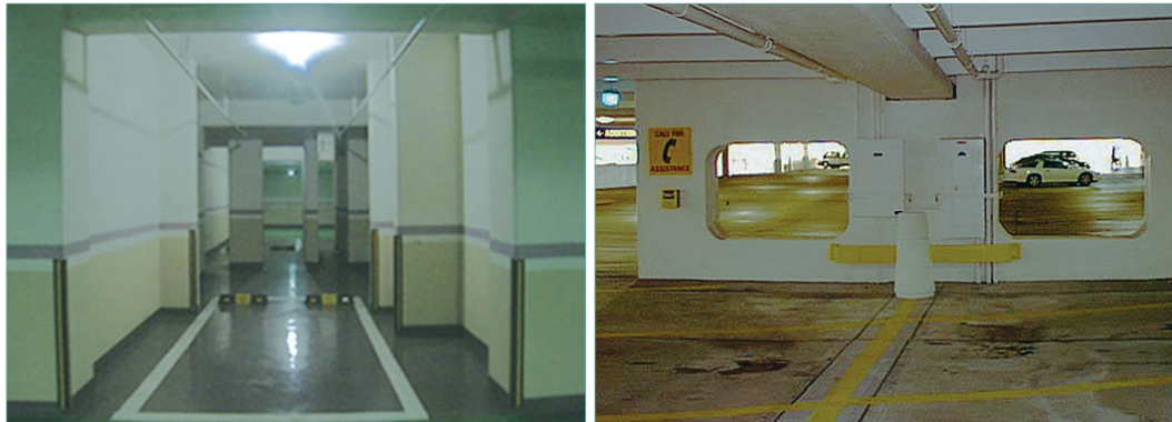
[그림 4-132] 투시형으로 개조한 주차장 벽면 출처: A guide to safe environments in Prince William County, Virginia, U.S.
