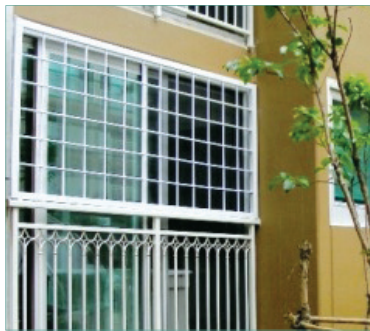
[그림 4-23] 적외선 입체탐지기와 방범창이 설치된 외부창문
