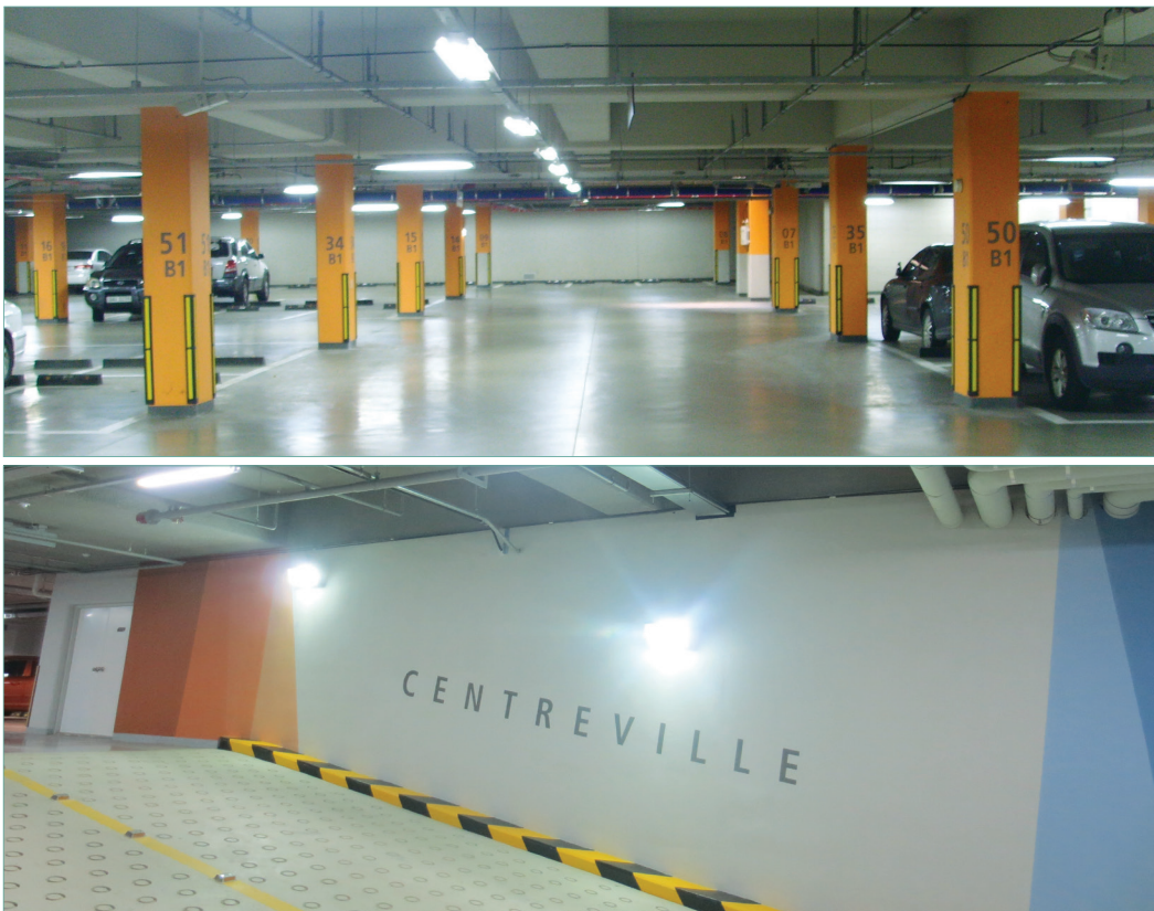
[그림 4-80] 야간 안전을 고려한 천장조명과 벽면조명 설치
