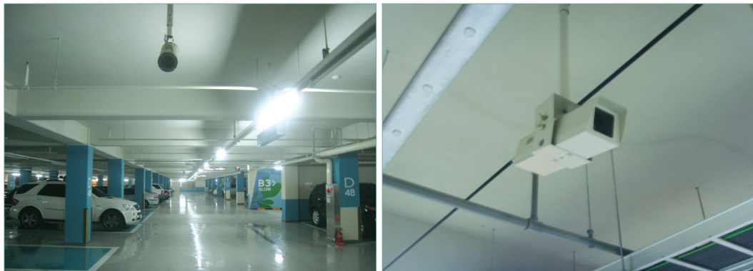
[그림 4-133] 지하주차장 주요지점에 설치된 CCTV
