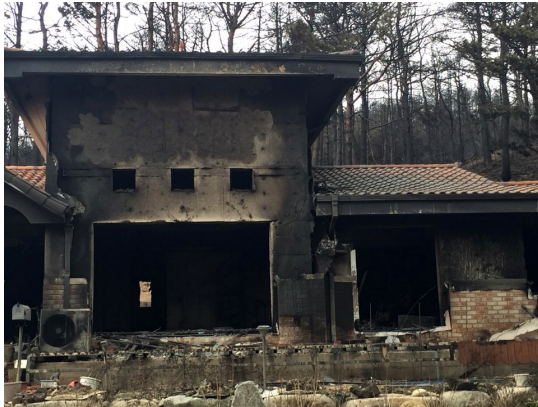
강원 산불로 폐허가 된 주택
