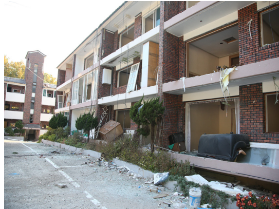
포항 지진 후 방치된 피해 공동주택
