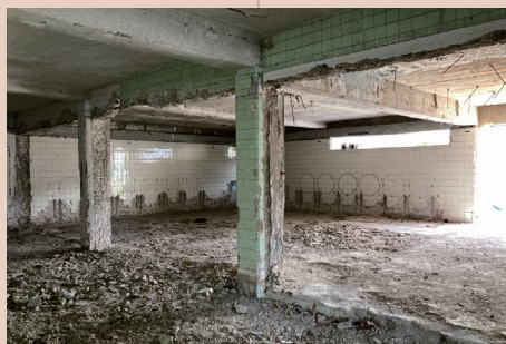
벽체 및 기둥에 남아있는 타일과 거울 및 배관의 흔적
