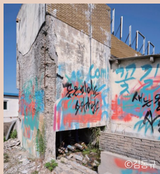
설비 배관 흔적
