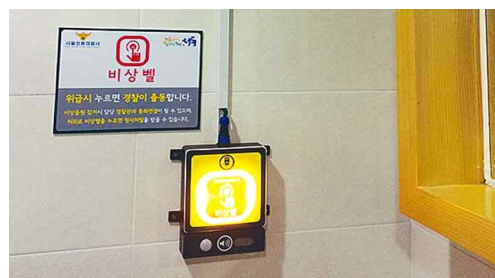
[그림 5-85] 지하철 여자화장실 설치 사례
